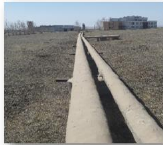
Дулааны шугам Дулааны станцаас Багануурын уурхайн хөрсний алсын овоолго тээвэрлэлтийн станцын барилга байгууламж конторыг холбосон цэвэр, бохир, дулааны шугам /одоогоор ашиглалтгүй/
